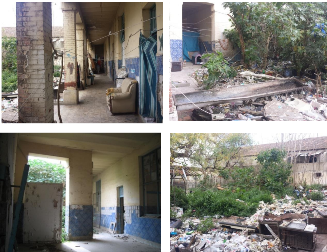
Fig. 1. L'état de dégradation de l'école oukalisée .
