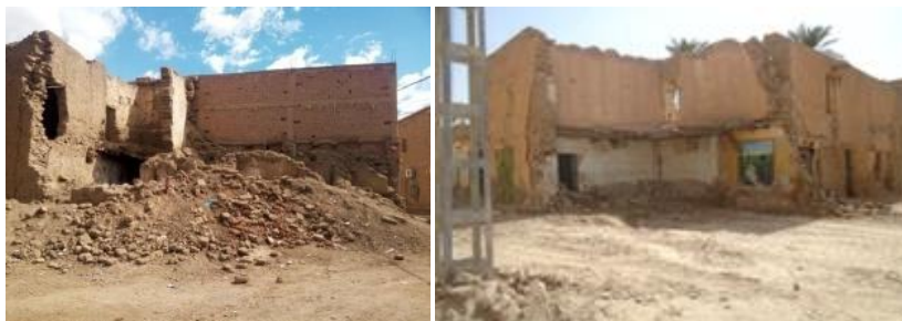
Fig. 7. Destruction partielle ou totale des habitations à Ourelal. (Source: Auteurs, 2018).
